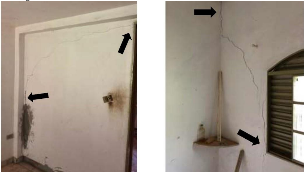
Figura 6 – Fissuras em alvenarias em uma residência familiar na cidade de Ceres/Go
