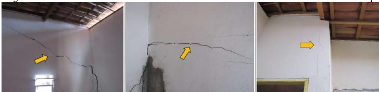
Figura 5 – Fissuras e rachaduras em residências na cidade de João Pessoa/PB devido ao recalque
