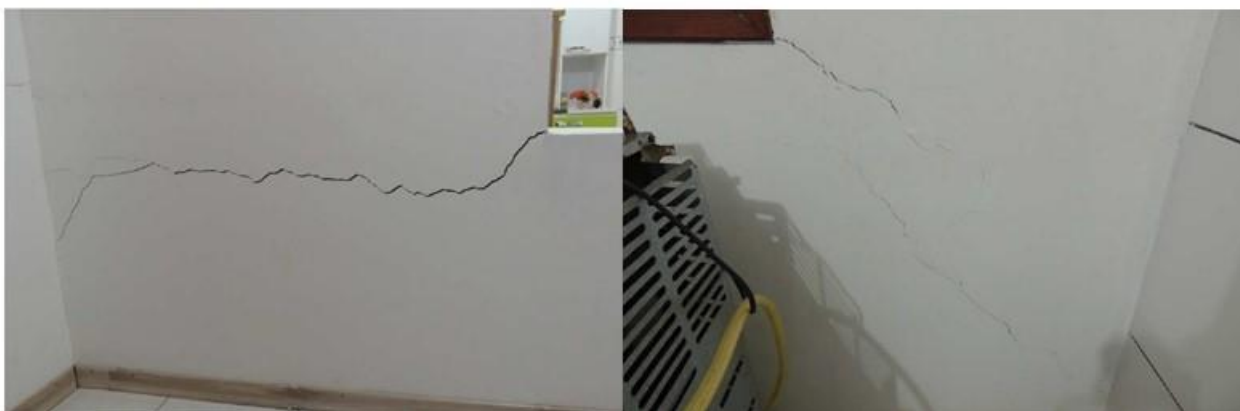
Figura 4 – Fissuras características de recalques em residência na cidade de Panambi/RS
