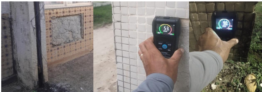
Figura 5 – Presença de umidade na base dos pilares
