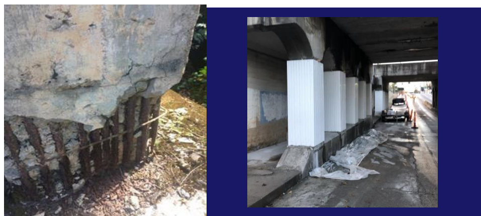
Figura 7 – Instalação de anodos galvashield DAS com o auxílio de jaquetas durante os serviços de reabilitação de pilares de concreto fora do mar.
