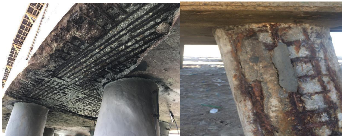
Figura 1 – Problemas de corrosão em píer de atracação de navios
