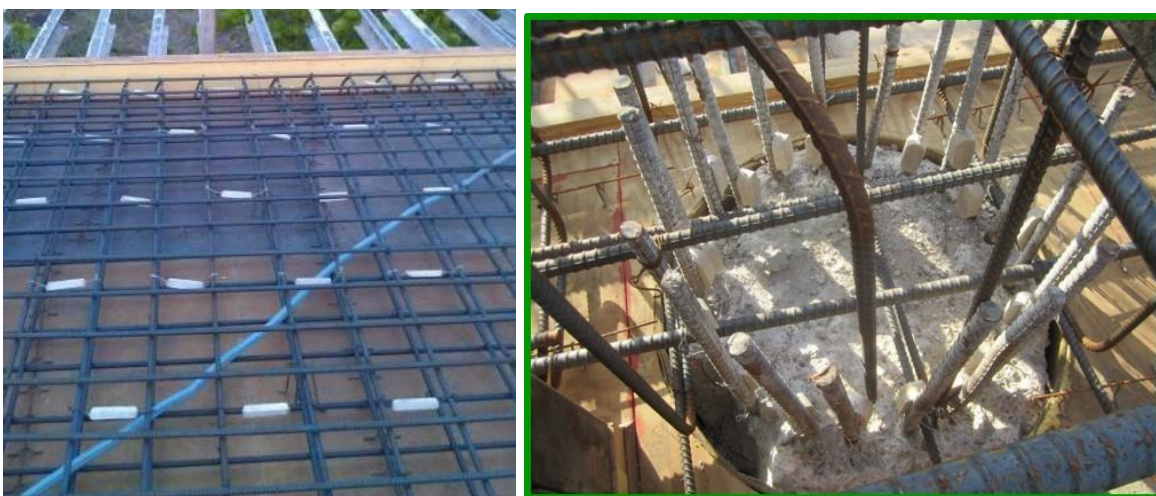
Figura 2 – Instalação de anodos galvashield N (peças brancas) durante a construção de novas estruturas de concreto.
