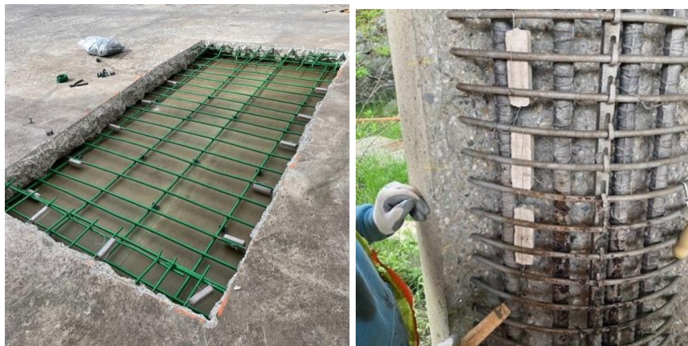
Figura 3 – Instalação de anodos galvashield XP (peças brancas) durante os serviços de reabilitação.
