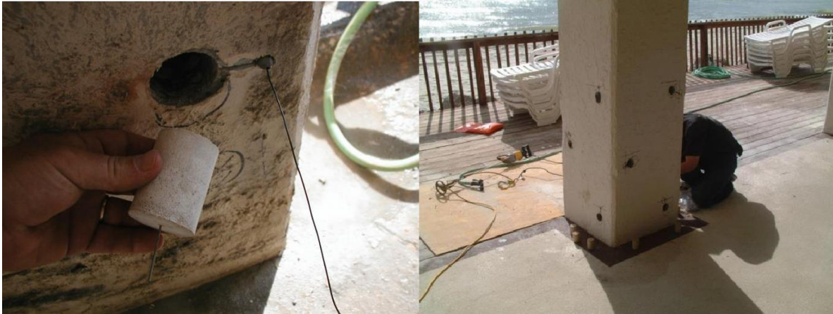
Figura 8 – Instalação de anodos galvashield CC em pequenos furos no concreto, nos locais onde a corrosão ainda não aflorou mas já está ativa.
