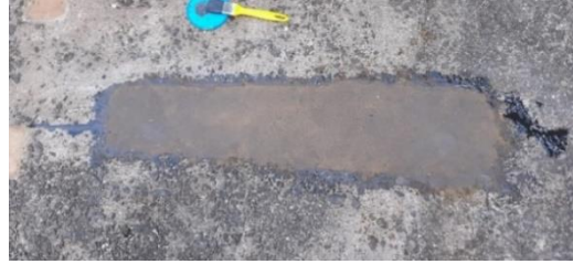
Figura 6 – Superfície de um reparo executado com argamassa a base de epóxi
