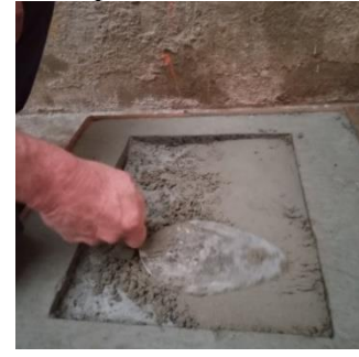
Figura 14 – Aplicação de material de reparo em área sem ponte de aderência.
