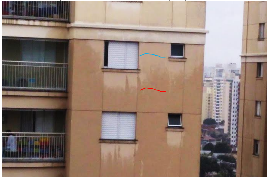
Figura 2 – Fachada de um prédio após a chuva com regiões mais e menos molhadas visíveis pela alteração da coloração. Foram desenhadas duas linhas que representam fissuras
