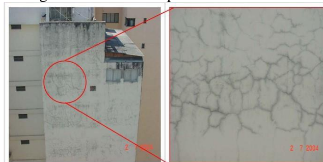
Figura 3- Fissuras mapeadas ou disseminadas
