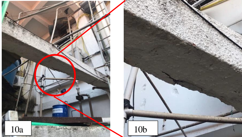
Figura 10: Viga da caixa d'água, a: Viga com manifestação patológica, b: Abertura da rachadura.
