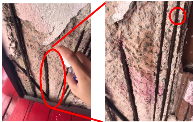
Figura 12: Laje da área técnica do laboratório, a: Laje com armadura exposta, b: Ensaio de carbonatação.
