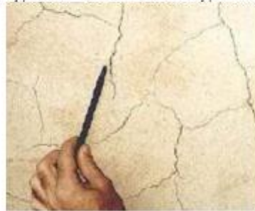
Figura 1 – Fissura em argamassa
